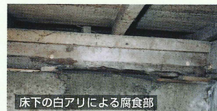
床下の白アリによる腐食部
